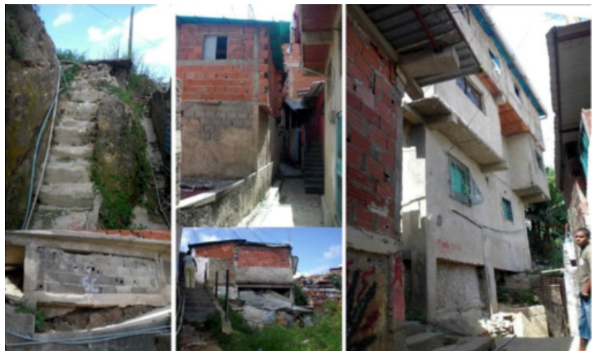
Foto 21 - Situación del sector sur, parte alta. Se muestra de densificación y algunas situaciones constructivas precarias en mal estado Fotografías: G.L.S., 2011.
