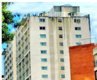
Figura 16. Efecto seiche en la piscina del techo del edificio del Hotel Pestana en Caracas.
