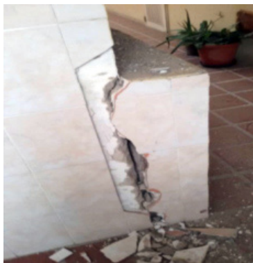
Figura 12. Daño en la estructura por efecto de columna corta en las Residencias Isla Plata, estado Anzoátegui.
