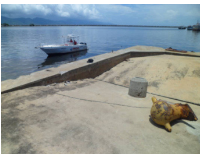
Figura 11. Daños en la losa del Muelle de Cariaco, estado Sucre, Venezuela.
