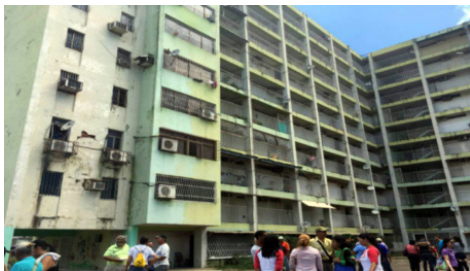
Figura 14. Edificios con daños en Ciudad Guayana (Bolívar), identificado como uno de los Bloques de Unare de 10 niveles.
