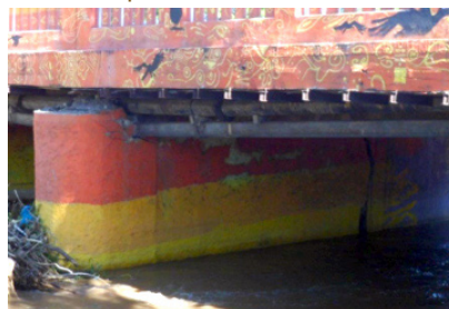
Figura 9. Daños estructurales en la pila central del puente Guzmán Blanco.
