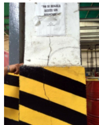
Figura 13. Grietas en columnas del Galpón de FEMSA en el estado Anzoátegui.
