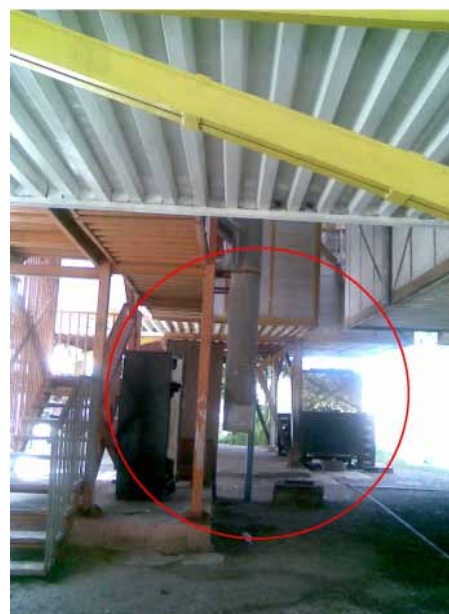
Imagen 16. Ductos de basura sin uso en las edificaciones, Urb. La Esperanza, Casalta, Caracas.
