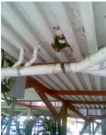
Imagen 18. Ductería y tableros de electricidad a la vista y deteriorados, Urb. La Esperanza, Casalta, Caracas.
