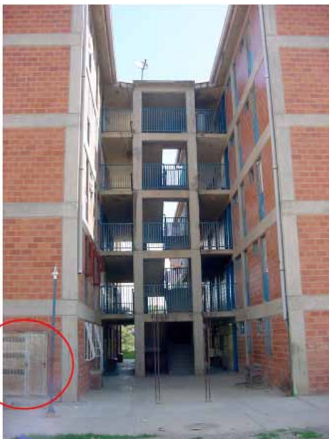
Imagen 21. Casetas de electricidad externas a la entrada en planta baja, Urb. Mata de Coco, Valles del Tuy, estado Miranda.
