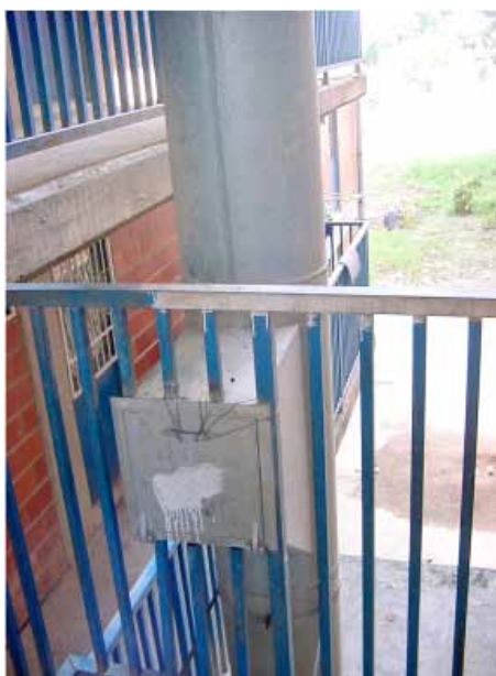
Imagen 14. Ductos de basura clausurados con alambres. Urb. Mata de Coco. Valles del Tuy, estado Miranda.
