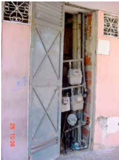
Imagen 19. Cuartos de medidores, Urb. Vicente Emilio Sojo. Guarenas, estado Miranda.
