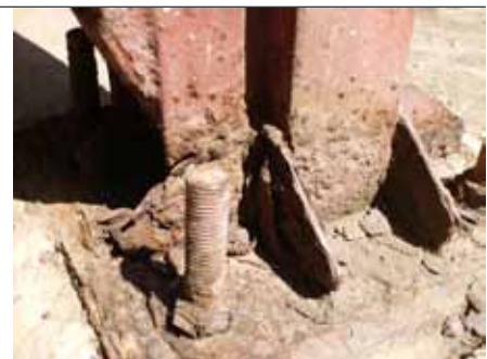
Foto 3 Urb. La Esperanza. Casalta Revisión daño en estructuras de soporte de la edificación
