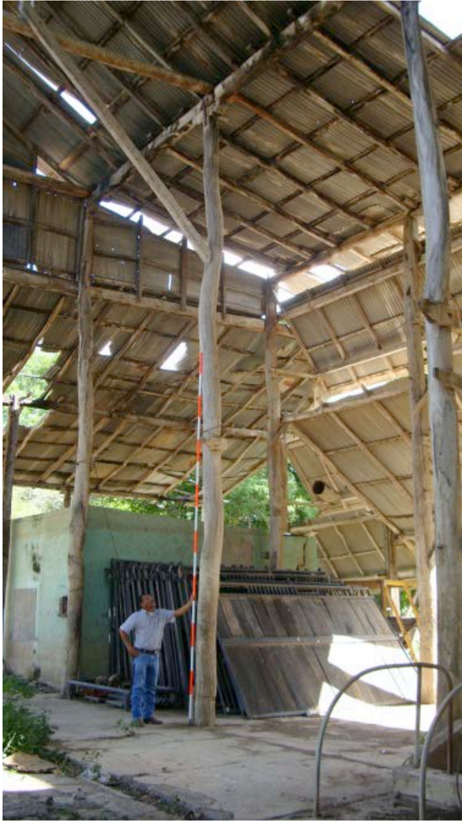
Fotografía 40: Central Sicarigua. Tirante reforzado con "pie de amigo" sobre el pilar.
