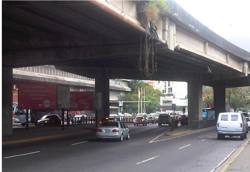
Imagen 4.10 Puente Veracruz II, Distribuidor El Ciempies- Las Mercedes. “pila multicolumna”. Fuente: Propia
