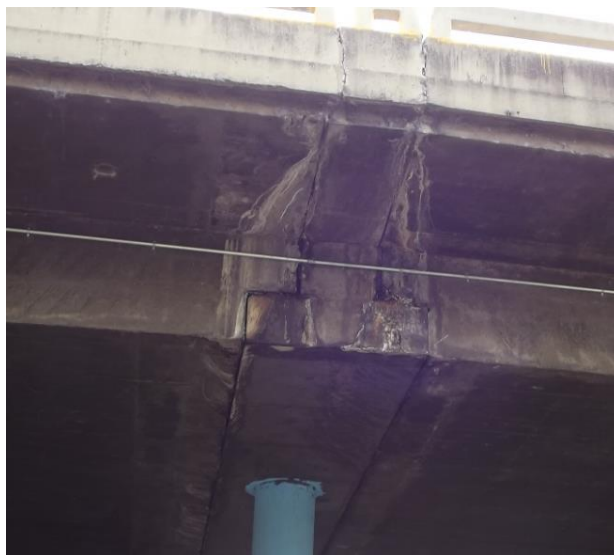
Imagen 5.17. Foto comparativa. Tramo elevado “Autopista Valle-Coche, rampa El Pulpo (tramos 20-23)”. Fuente: Propia
