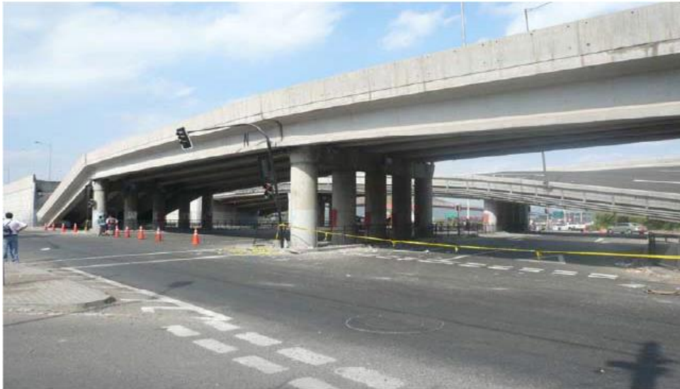
Imagen 2.4 Colapso de tablero. Fuente: Artículo; Daños Producidos en puentes y estructuras por el terremoto del 27 de Febrero de 2010 en Chile (Cordova, 2011).
