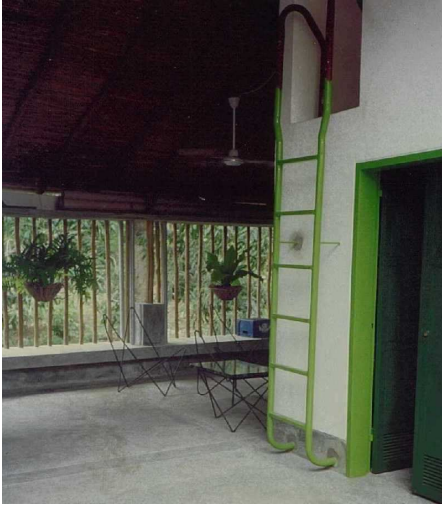
Contraste de colores en elementos de herrería (imagen tomada durante el proceso de pintura de la obra).
