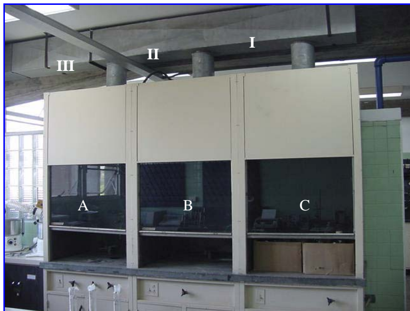
Figura 3.12 Sistema de Extracción 2 (LAI)
