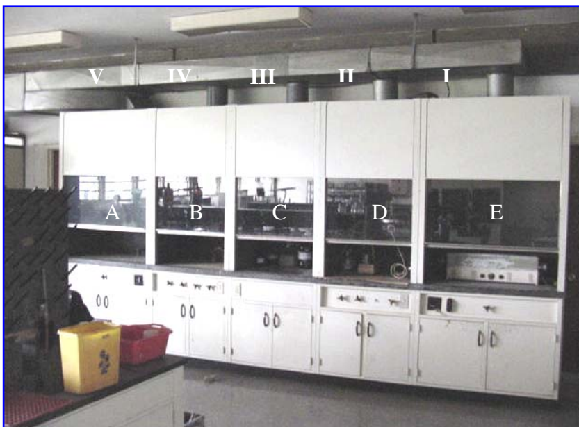
Figura 3.20 Sistema de Extracción 1 (LTF)
