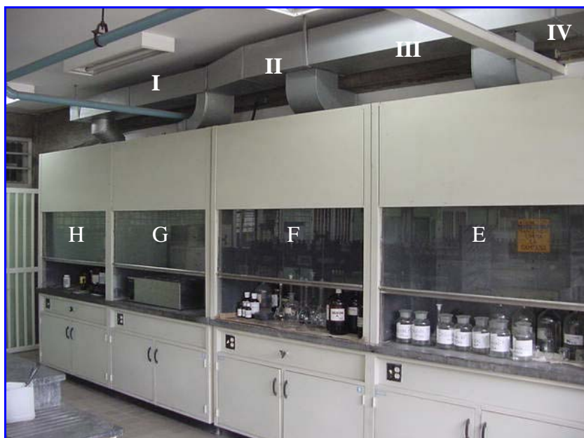
Figura 3.6 Sistema de Extracción 2 (LQG)
