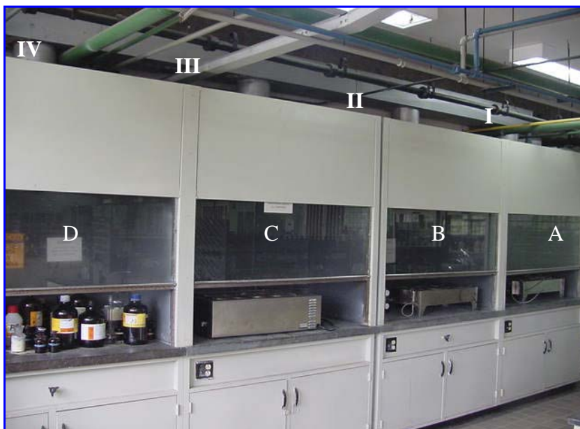
Figura 3.5 Sistema de Extracción 1 (LQG)
