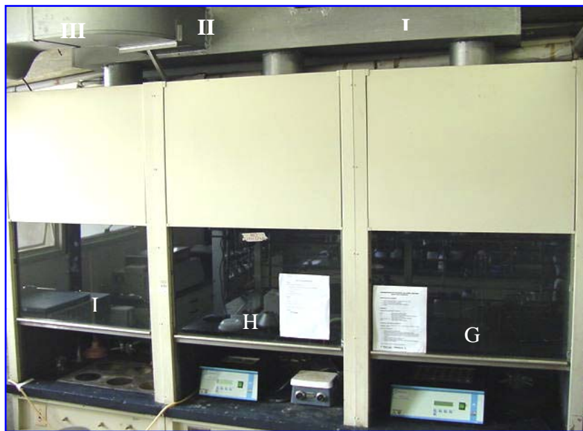
Figura 3.17 Sistema de Extracción 2 (LBR)
