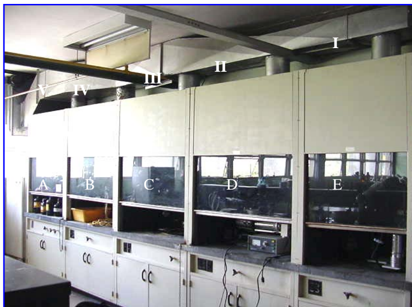
Figura 3.15 Sistema de Extracción 1 (LMO)
