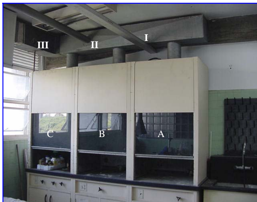
Figura 3.11 Sistema de Extracción 1 (LAI)
