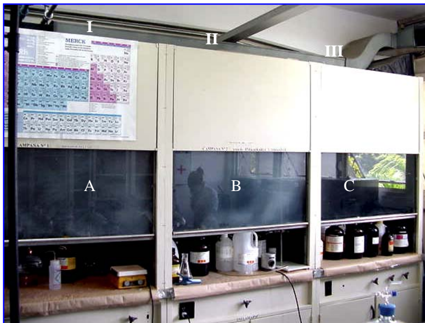
Figura 3.10 Sistema de Extracción 1 (LCC)
