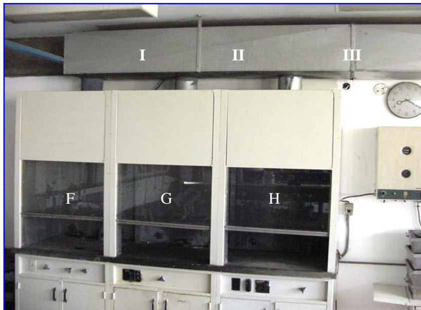
Figura 3.21 Sistema de Extracción 2 (LTF)
