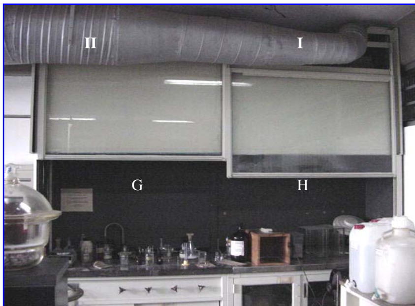
Figura 3.2 Sistema de Extracción 2 (LUSM)
