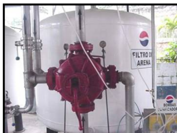
Figura 2.5. Filtro de Arena
