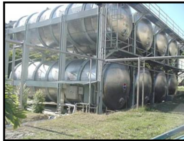
Figura 2.17. Tanques de Acero Inoxidable
