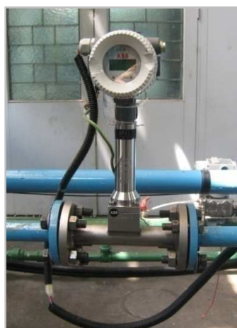
Figura 16. Medidor de Flujo (Vortex 1 pulgada de diámetro).
