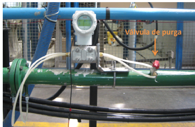
Figura 21. Sistema de purga del medidor de presión diferencial.
