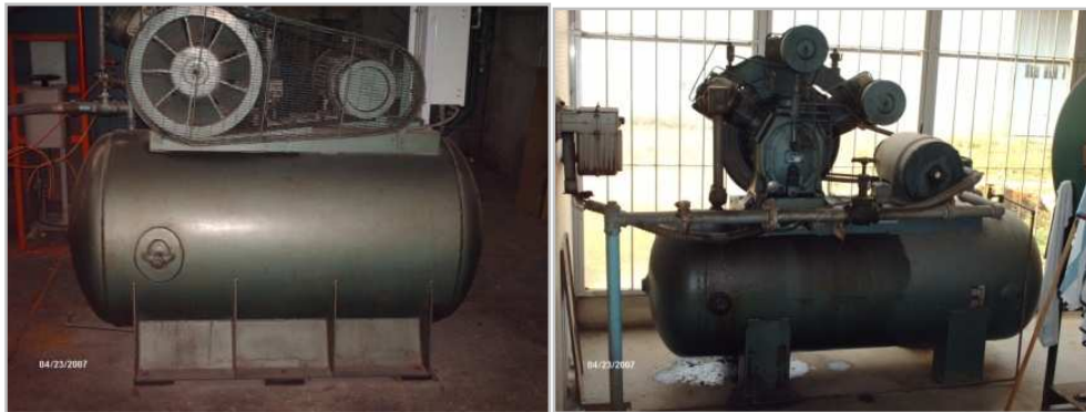
Figura 5. Compresor del galpón (Izquierda), Compresor sala de calderas (Derecha) (Toro y Suarez, 2007).
