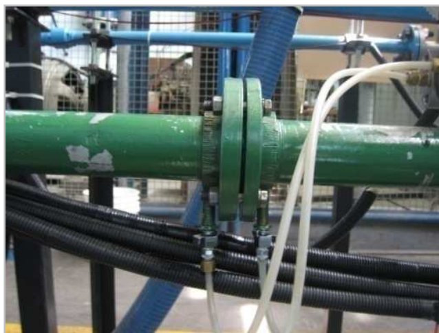
Figura 9. Tomas en la brida para la medición de presión diferencial.
