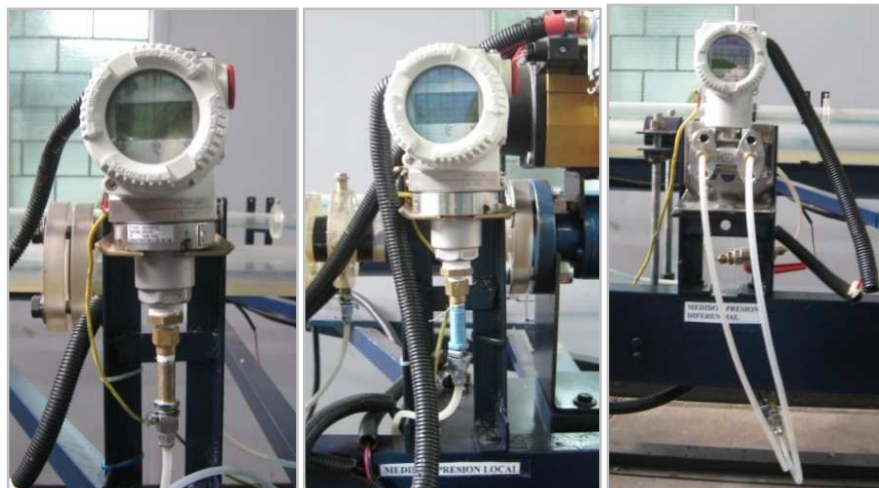
Figura 19. Medidor de presión local 1 y 2 y medidor de presión diferencial.
