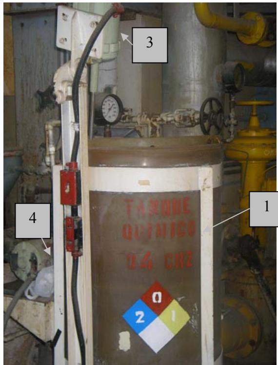
Fig. n°20. Tanque de fosfato y componentes en nivel de sala de máquinas Fuente: propia
