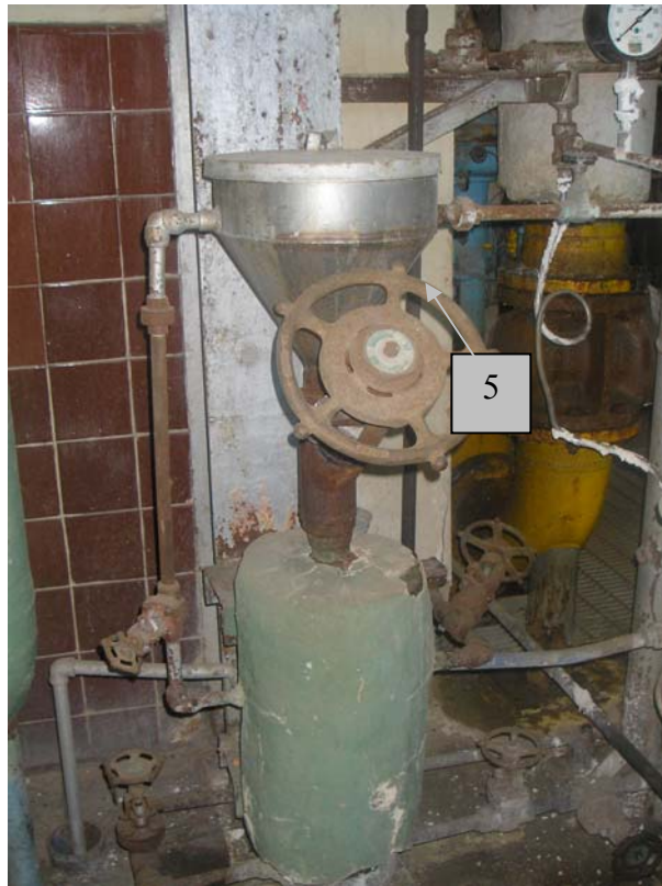
Fig. nº22. Sistema auxiliar de inyección de fosfato. Fuente: propia
