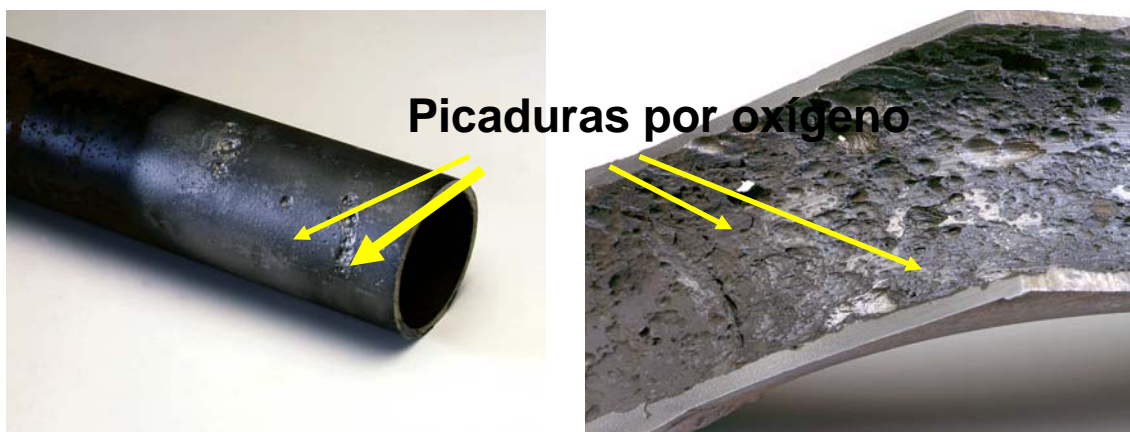
Figura nº9. Ataque de corrosión por oxígeno en tubo.
