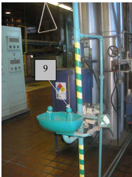
Fig. n°19. Regadera de seguridad Fuente: propia
