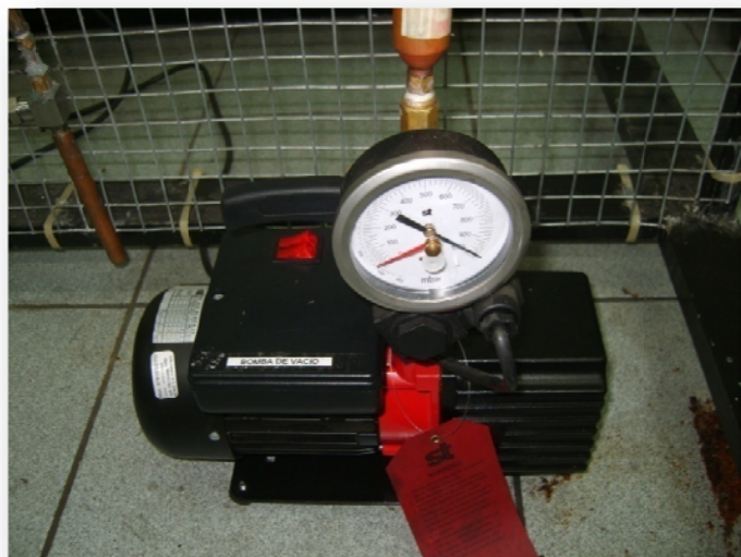
Figura B4. Bomba de vacío acoplada al sistema de llenado
