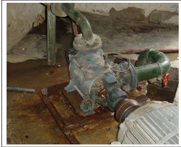
Figura 4.11 Fugas que presentan las bombas de la estación
