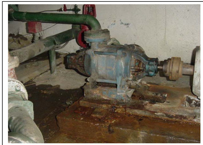
Figura 4.6 Estado de deterioro de las fundaciones de los grupos moto-bombas
