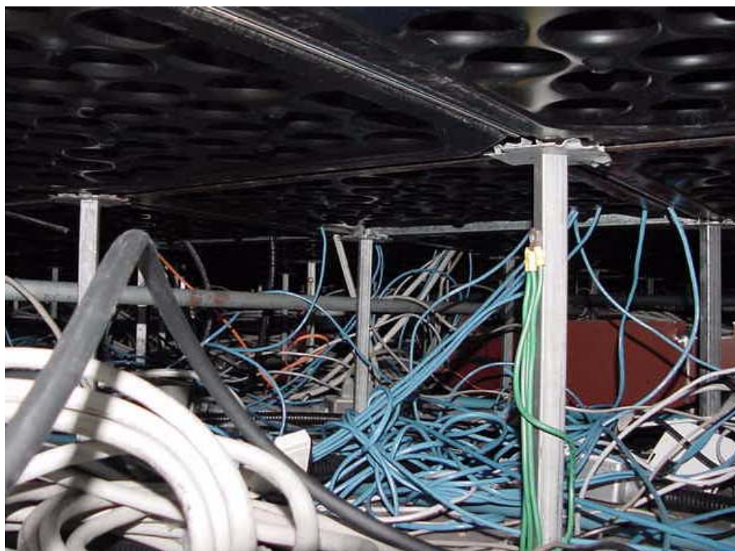
Cableado del Piso Falso
