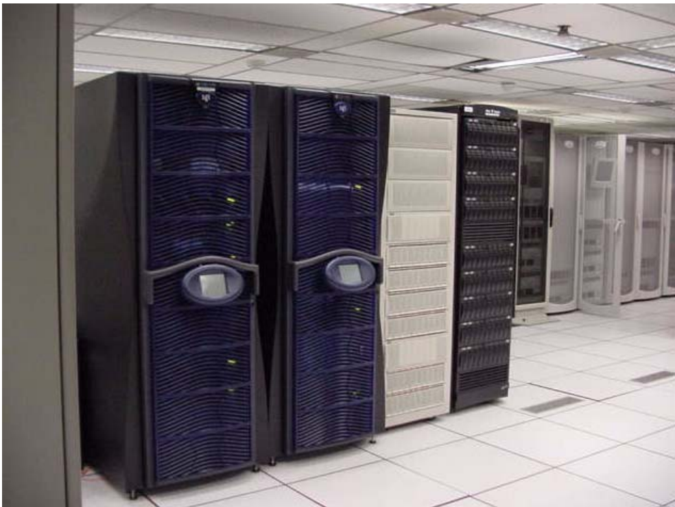
Máquinas instaladas en el Área 1
