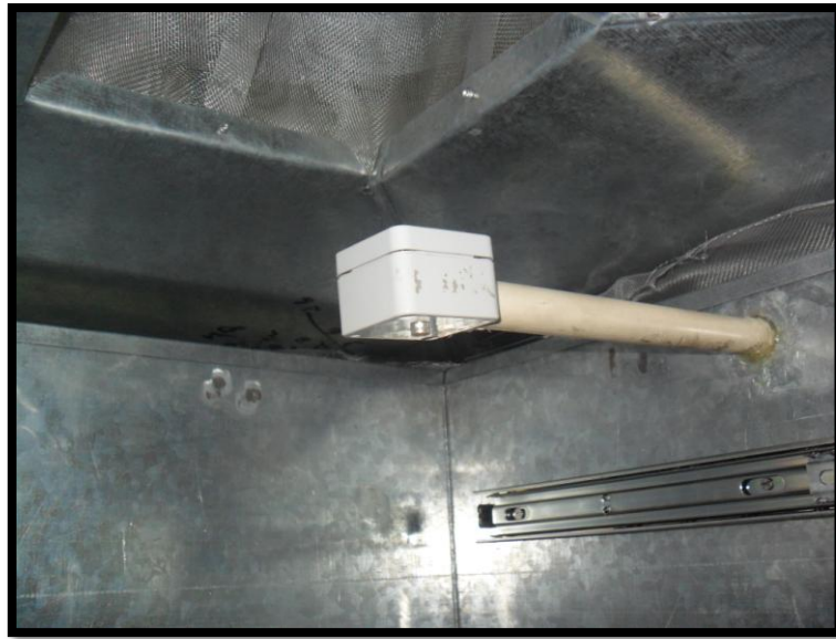
Figura 5.9 “Medidor de temperatura y humedad H1H-4602-A/C dentro de la cámara de secado”
