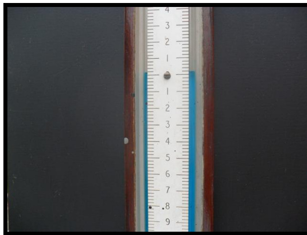
Figura 5.6 “Manómetro diferencial tipo U del colector solar”
