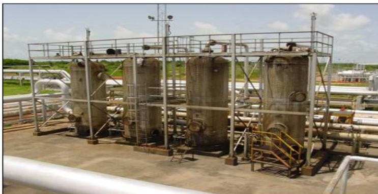
Figura 16. Reactores de endulzamiento con lecho sólido del Complejo Operativo Muscar
