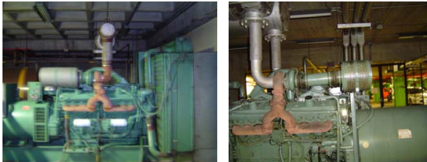
Fig. 4.8. Plantas de emergencia. La foto de la izquierda muestra la planta de emergencia N° 2, mientras la foto de la derecha la planta de emergencia N° 1.
