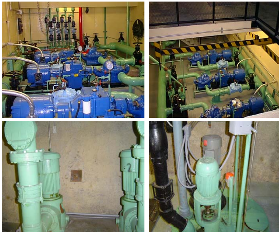
Fig. 4.12. Equipos del sistema sanitario. Fotos superiores, bombas de aguas blancas. Fotos inferiores, de izquierda a derecha: bombas de aguas de lluvia, bombas de aguas negras.
