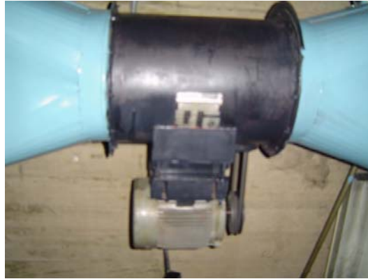
Fig. 4.6. Equipo del subsistema de ventilación forzada. Ventilador axial para la extracción de aire en el estacionamiento.
