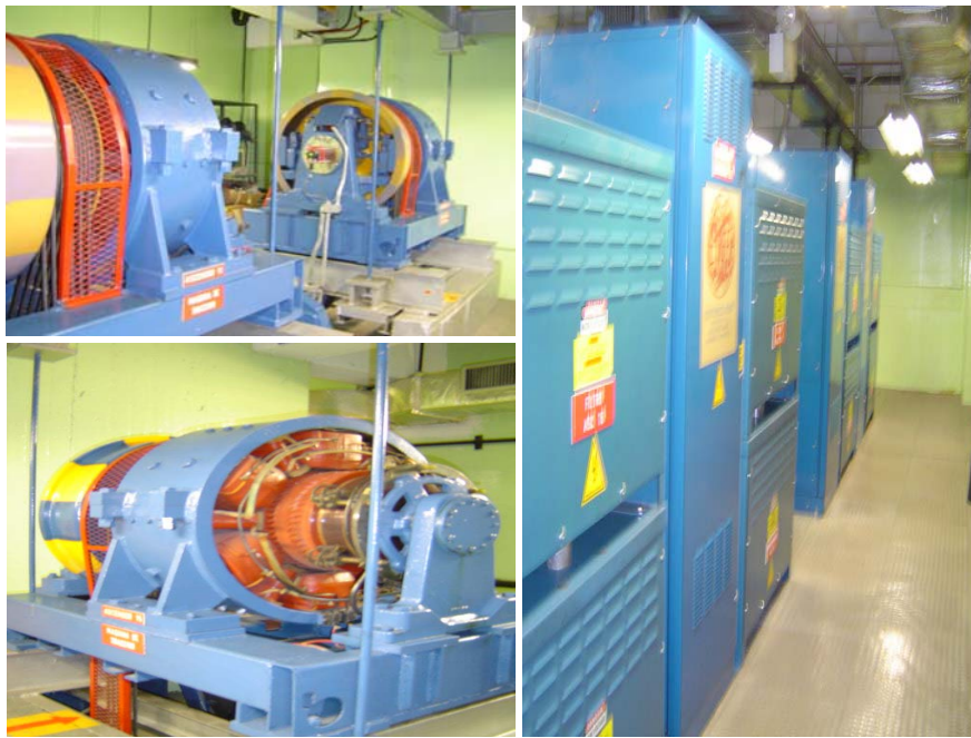
Fig. 4.11. Equipos del sistema de ascensores. Las fotos de la izquierda muestran los motores de la sala de máquinas. La foto de la derecha contiene a los tableros de control de movimiento de las unidades.
