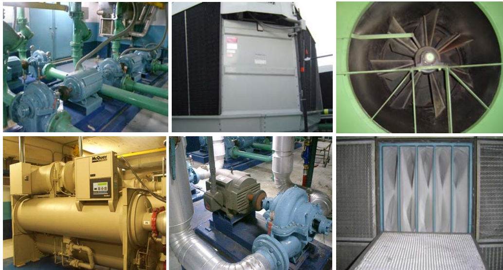
Fig. 4.5. Equipos que conforman el subsistema de aire acondicionado central de agua helada. Fotos superiores, de izquierda a derecha: bombas de condensación, torre de enfriamiento, ventilador de la sala de manejo de aire. Fotos inferiores, de izquierda a derecha: chiller, bomba de agua helada, filtros de la sala de manejo de aire.
