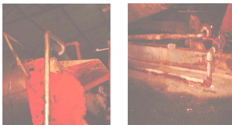
Figura N° 16: Sistema de reciclo de los botales
