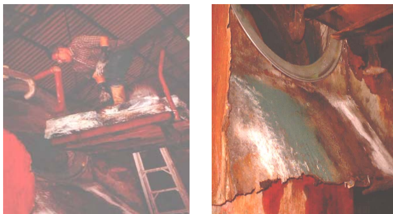
Figura N° 17: Pérdidas de productos químicos.
