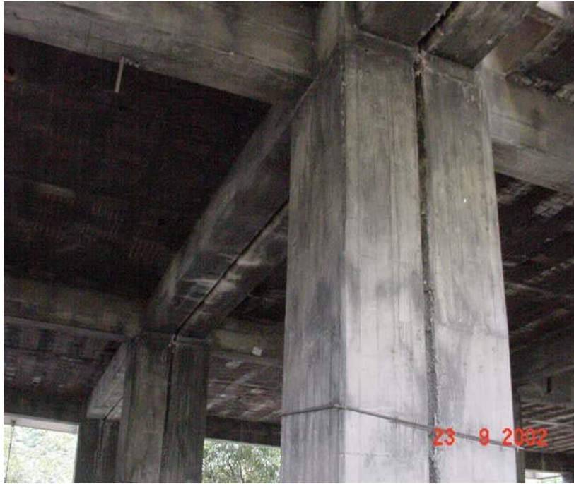
Fotografía VI.11: Color Negrusco en Elementos Estructurales de la Planta Baja por Efecto del Fuego
