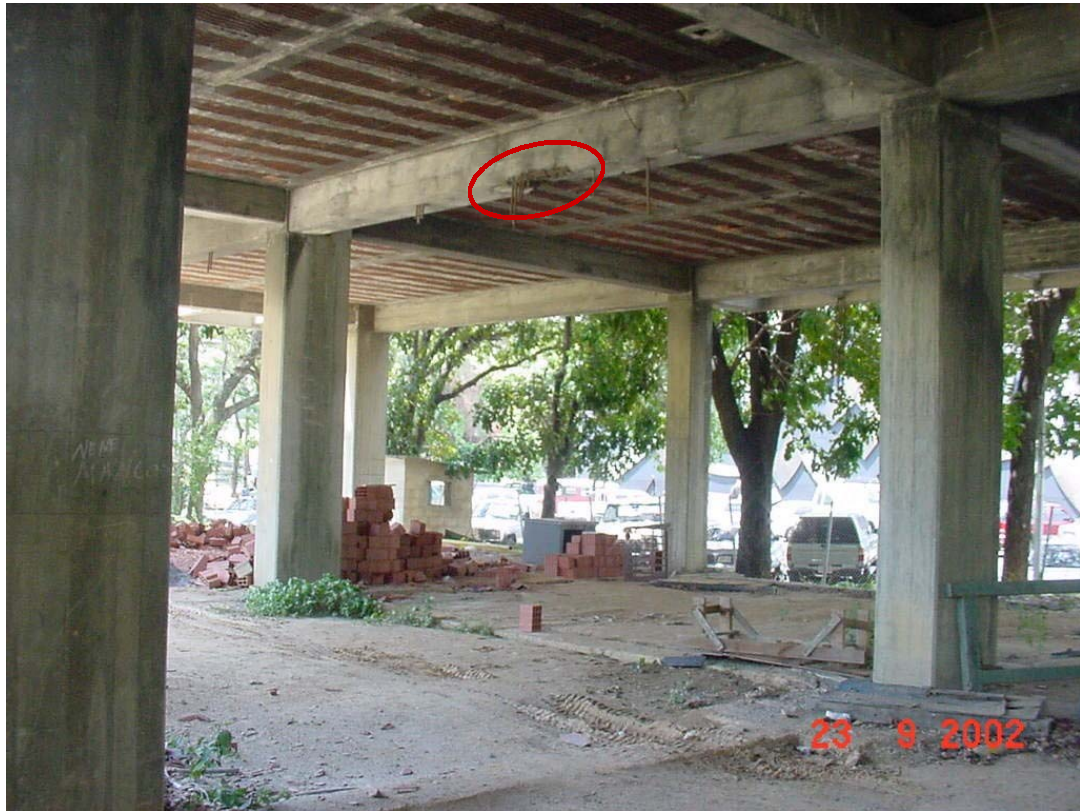
Fotografía VI.7: Cangrejera en la Viga 2 del Pórtico B
