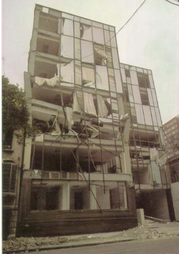
Fotografía IV.3: Colapso de un Edificio por Falla de Columnas (Columnas Débiles) ( http://www.ssn.unam.mx/SSN/Doc/Sismo85/Fotos/fl.htm )
