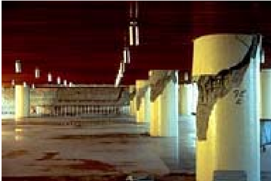
Fotografía IV.8: Colapso por Entrepiso Débil ( http://nisee.berkeley.edu/eqiis_earthquakes.html )
