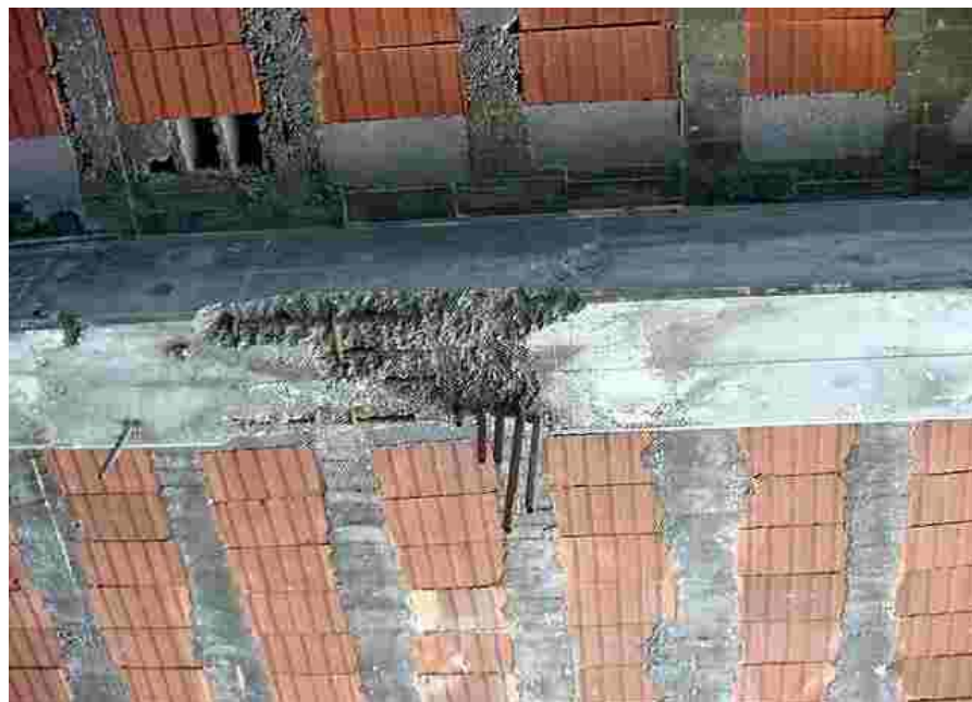
Fotografía VI.8: Detalle de la Cangrejera en la Viga 2 del Pórtico B
