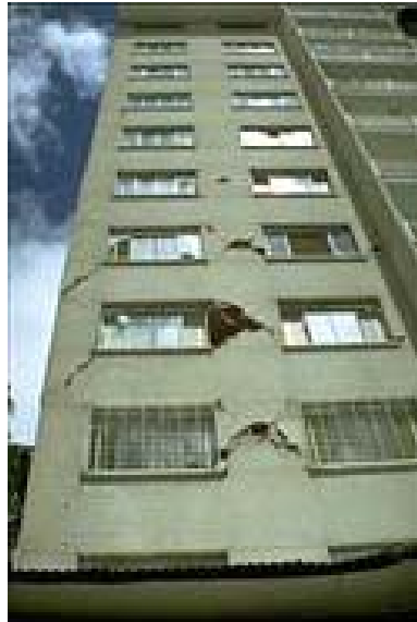
Fotografía IV.7: Falla de Columnas (Columnas Cortas) ( http://nisee.berkeley.edu/eqiis_earthquakes.html )
