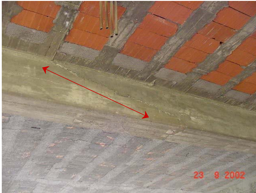
Fotografía VI.12: Junta de Vaciado en Viga del Pórtico B en el Nivel “Techo”
