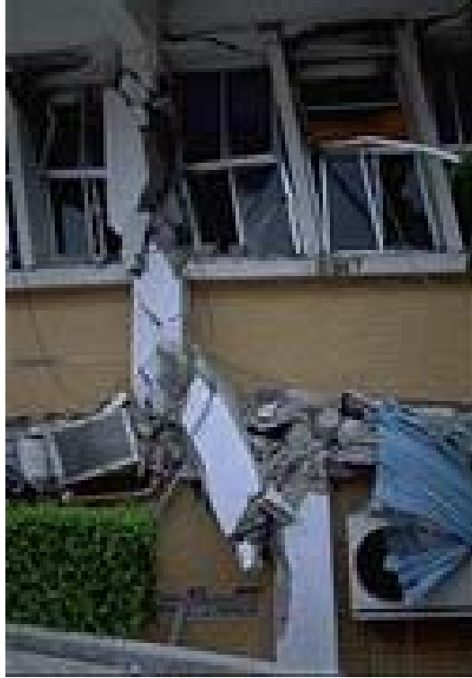
Fotografía IV.6: Colapso de un Edificio por Falla de Columnas (Columnas Cortas) ( http://nisee.berkeley.edu/eqiis_earthquakes.html )
