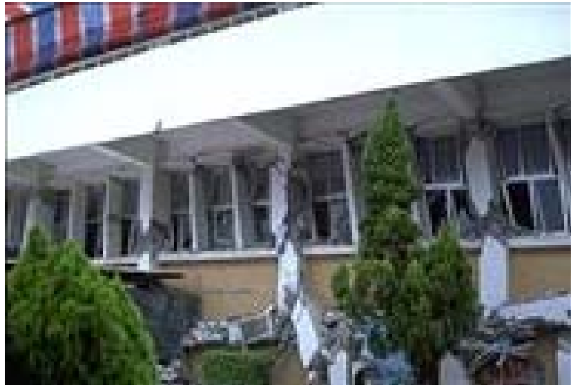
Fotografía IV.5: Colapso de un Edificio por Falla de Columnas (Columnas Cortas) ( http://nisee.berkeley.edu/eqiis_earthquakes.html )
