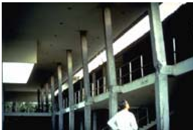
Fotografía IV.4: Falla por Columnas Débiles ( http://nisee.berkeley.edu/eqiis_earthquakes.html )
