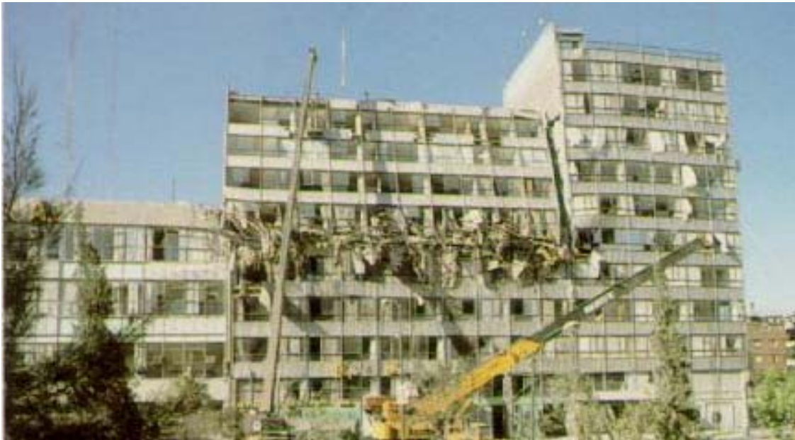
Fotografía IV.12: Caso de Falla por Colindancia o Adyacencia ( http://www.ssn.unam.mx/SSN/Doc/Sismo85/Fotos/fl1.htm )
