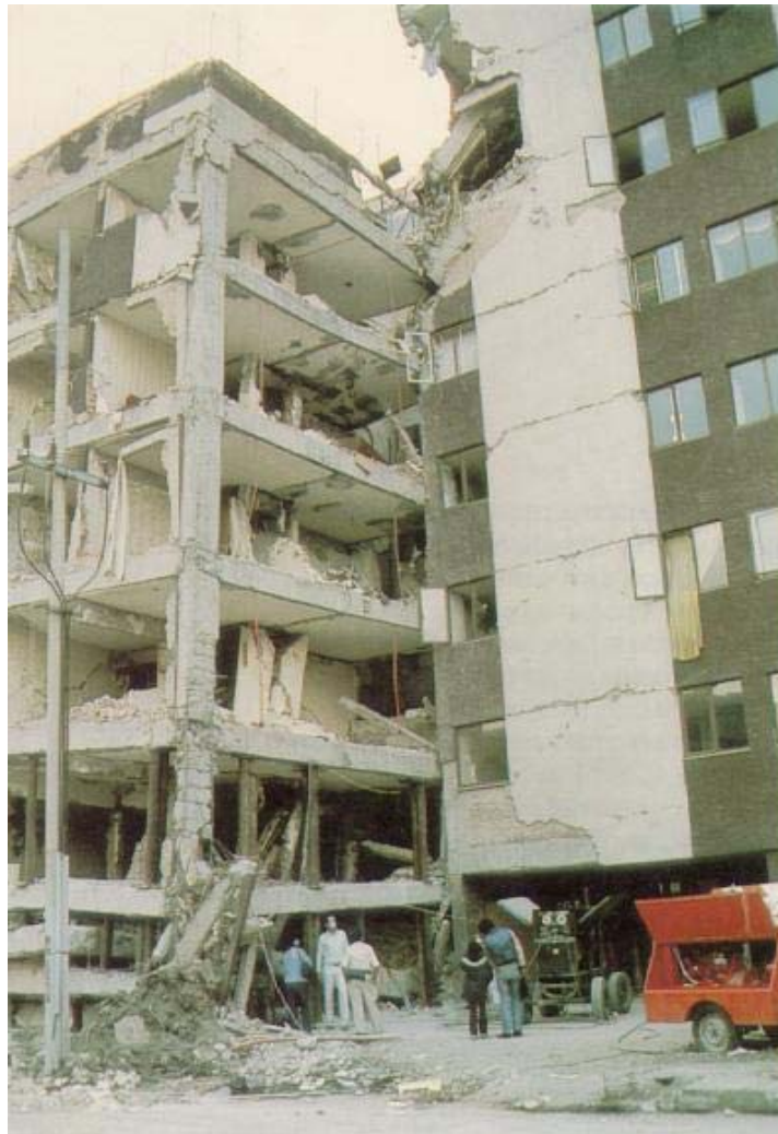
Fotografía IV.11: Caso de Falla por Colindancia o Adyacencia ( http://www.ssn.unam.mx/SSN/Doc/Sismo85/Fotos/fl.htm )
