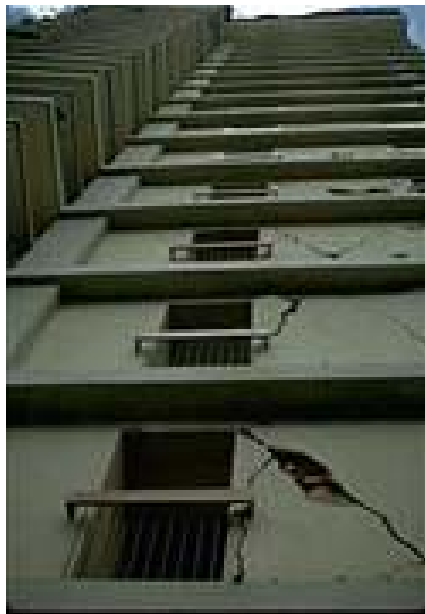
Fotografía IV.10: Excesiva Flexibilidad de la Estructura ( http://nisee.berkeley.edu/eqiis_earthquakes.html )
