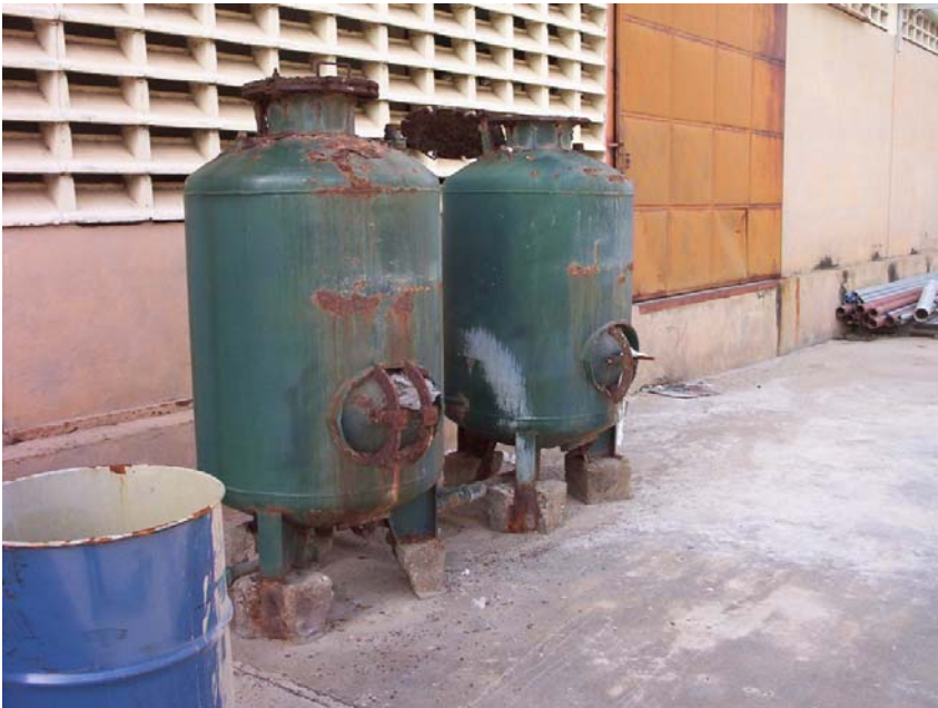
Figura 9.4.- Filtros de sistema de agua suavizada desincorporados
