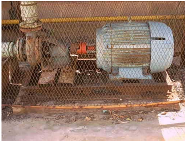
Figura 9.2.- Bomba de agua cruda antes del inicio de la nueva gestión de mantenimiento.
