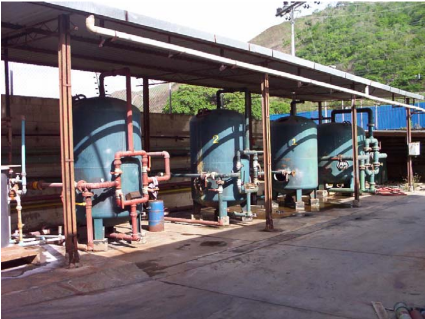
Figura 9.5. Sistema de agua suavizada resultante, después de la desincorporación de filtros
