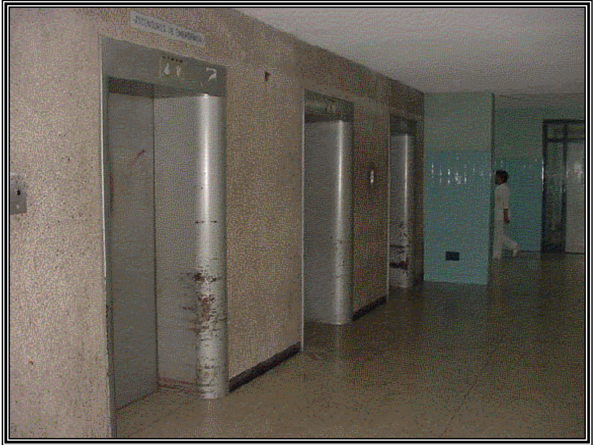
Figura 7. Puertas de Pasillo (piso 1) de los ascensores 2, 3 y 4 (hospitalización).
