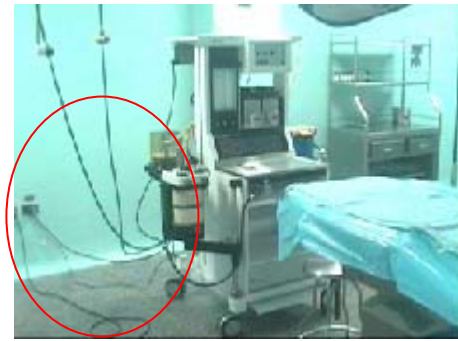
Fig.1.21. Cables y mangueras de alimentación de la máquina de anestesia.
