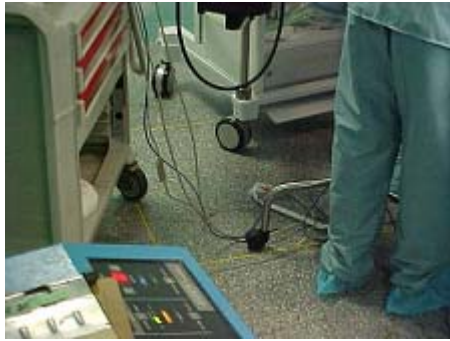
Fig. 1.12. Cables en el paso del personal.
