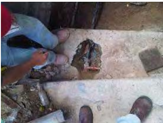
Foto 5-7: Construcción de acueducto y alcantarillado condonial en el sector La Palomera, municipio Baruta. Estado Miranda. Detalle de la construcción de espacio para caja de acceso a llave de paso rápida (50 mm) de acueducto. Tubería PEAD.
