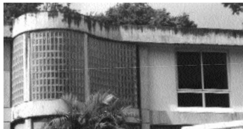
Figura 103 Detalles de bloques de iluminación
