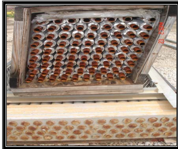
Figura 40: Tubos de un intercambiador de calor (tipo AC-206)
