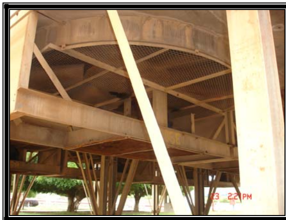
Figura 41: Vista de parte de los ventiladores del condensador AC-206 A
