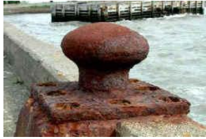
Figura 2: Corrosión uniforme observado en un punto de apoyo de amarre de embarcaciones marinas. (NACE International Resource center, ©2000-2010)
