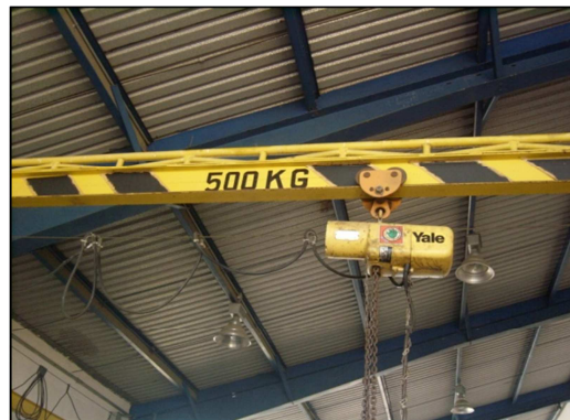
Fig. IV.39: Grúa Puente den el área de chequeo
