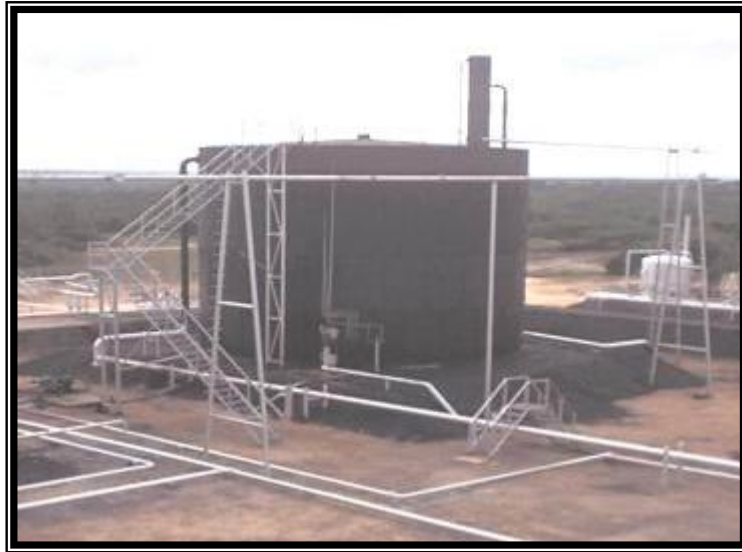
Figura 2.4. Tanque de Lavado [17].
