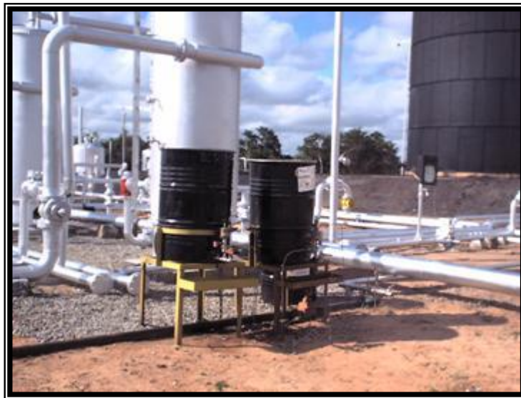
Figura 2.3. Unidad de Adición de Químicos [15].
