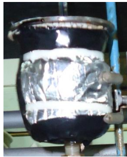
Figura N° 13. Tanque del sistema aislado
