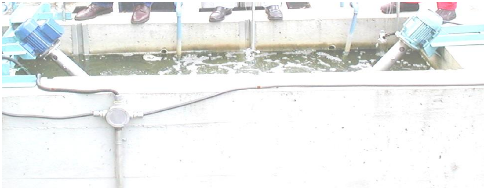
Figura N° 7. Tanque de aireación del sistema de lodos activados ubicado en la PETA.
