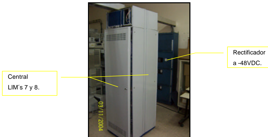
Figura 27. Central Edif. Telecom Industrial - Pequiven Morón.
