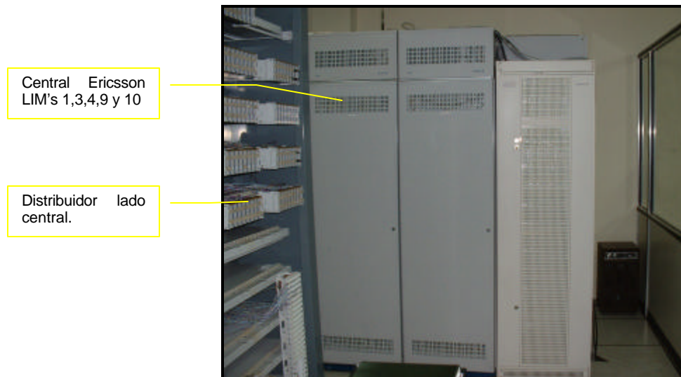
Figura 40. Central Telefónica AIT- Pequiven Tablazo.
