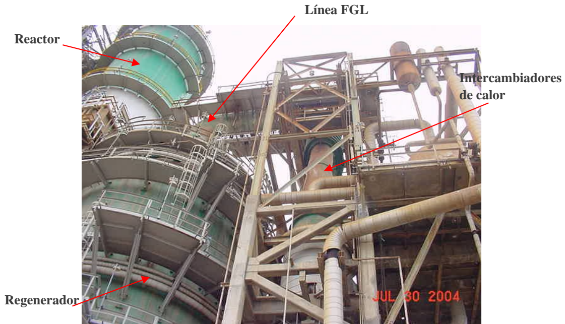
Figura 5. Unidad de desintegración catalítica, vista actualmente.
