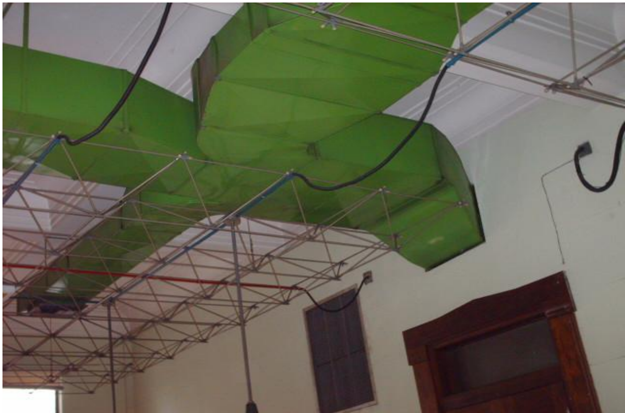
Foto N° 10. Sistema de Aire Acondicionado
