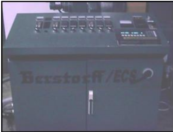
Figura N°21. Panel de control de la extrusora.
