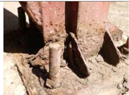
Foto 3 Urb. La Esperanza. Casalta Revisión daño en estructuras de soporte de la edificación
