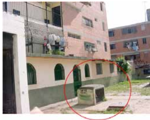
Imagen 20. Tanques de agua cercanos a las ampliaciones de las viviendas de planta baja, Urb. Las Mercedes. La Victoria, estado Aragua.
