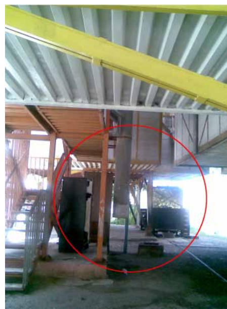
Imagen 16. Ductos de basura sin uso en las edificaciones, Urb. La Esperanza, Casalta, Caracas.
