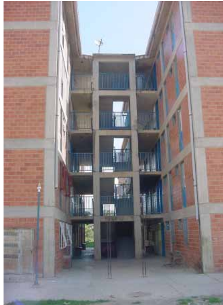
Imagen 12. Núcleo de pasillos y escaleras en Urb. Mata de Coco, Valles del Tuy, estado Miranda
