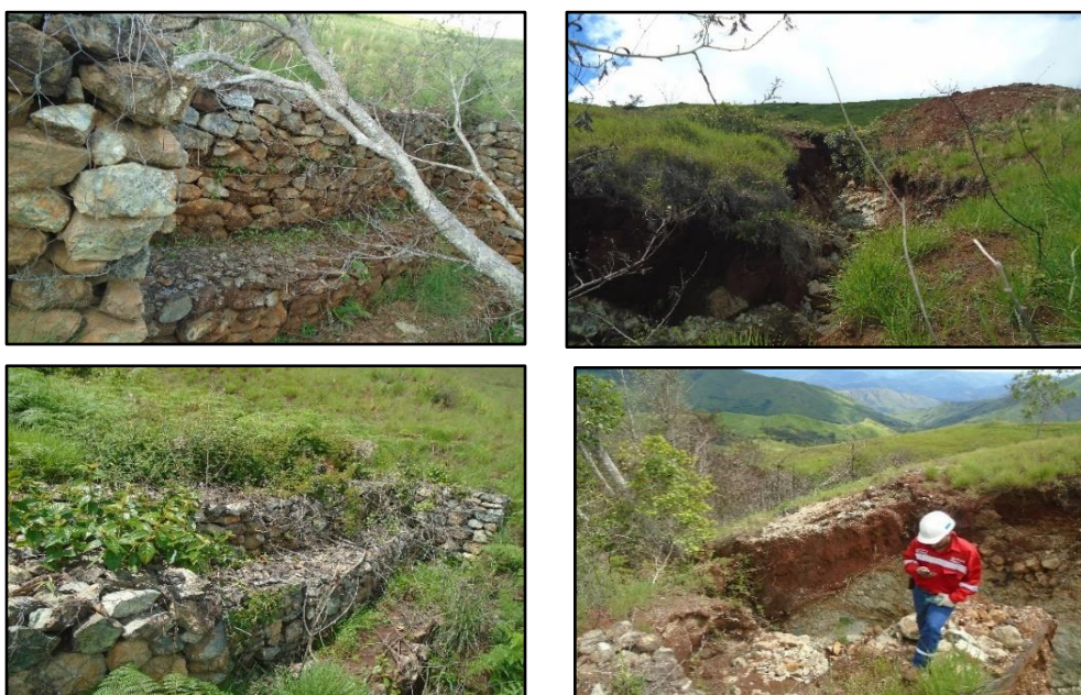
Figura 6.30. Fotografía gaviones ubicados en el sector III, en donde se depositan los sedimentos provenientes de la quebrada Amarilla.
