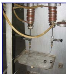
Figura N° 27. Serpentines de cobre.
