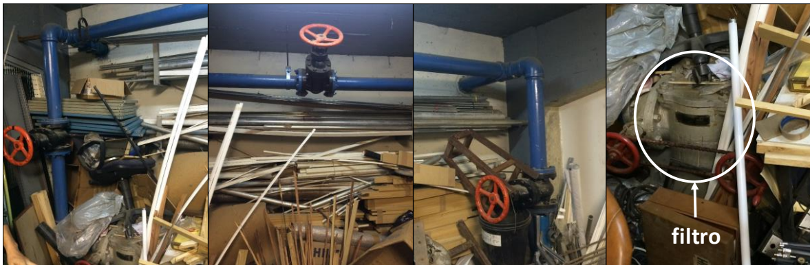
Figura 30. Tubería de aducción y filtro ubicados en el sótano
