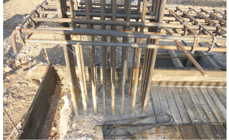
(6) Amarre entre vigas de fundación y columnas.
