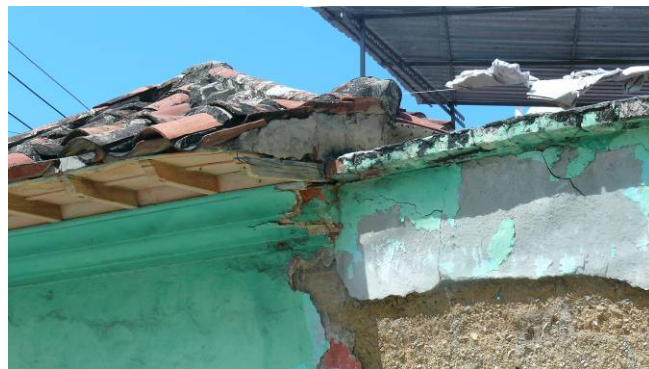
Figura 10. Desprendimiento de friso en Fachada Fuente: IERU-USB
