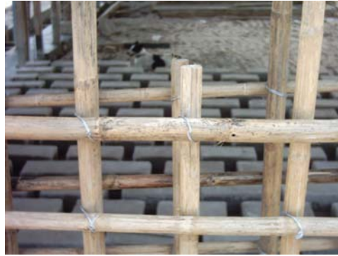
Figura 12: Unión entre cañas con alambre dulce Capilla San Antonio, Edo Zulia Fuente: Elaboración propia (2007)
