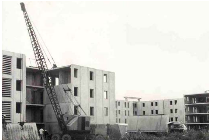
Figura 1 Proceso de construcción de viviendas multifamiliares Sistema A-4 Arellano, A., Tomo I, p. 231.
