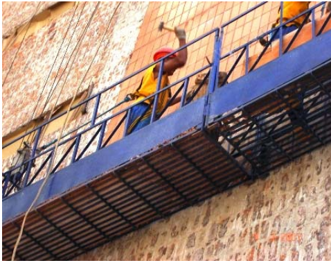
Figura 4 - Retirada do revestimento apenas com a marreta, aumentando o risco de acidentes na edificação E.
