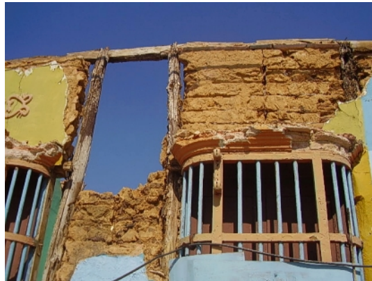
Figura 2: Pérdida de dimensiones Casa en Maracaibo, Edo Zulia Fuente: Elaboración propia (2006)
