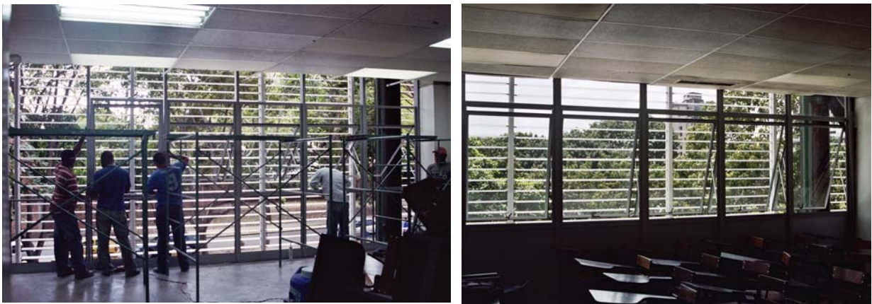
Figura 15. Proceso de colocación de las ventanas y vista interior del aula con el sistema de ventanería instalado. Fuente: Arq. David Viloría
