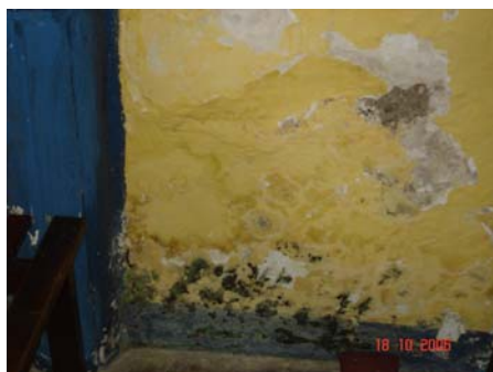
Figura 6: Humedad y moho en friso Capilla San Antonio, Edo Zulia Fuente: Arquiluz (2006)
