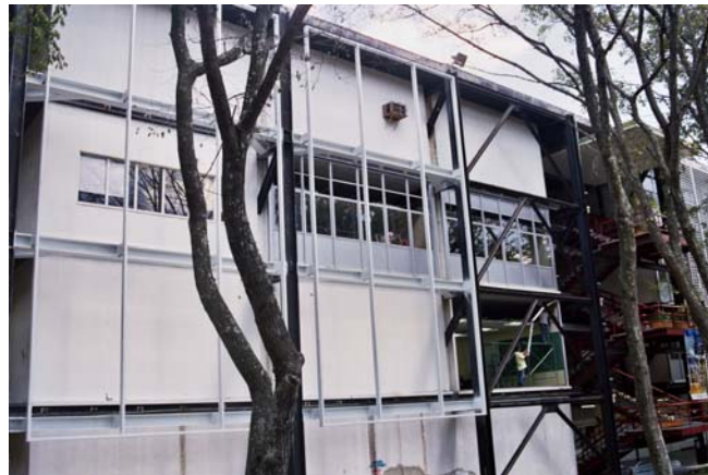
Figura 11. Vista de la colocación de las ventanas en el extremo oeste de la fachada sur Fuente: Arq. David Viloría
