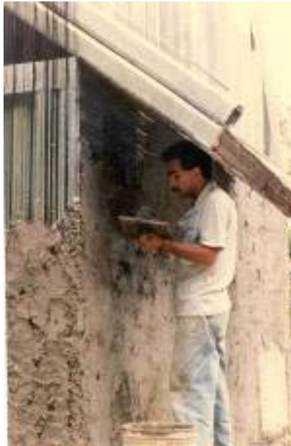
Figura 2.- Aplicación de revestimientos en húmedo con malla Stucanet. Tomado de archivos Sipromat
