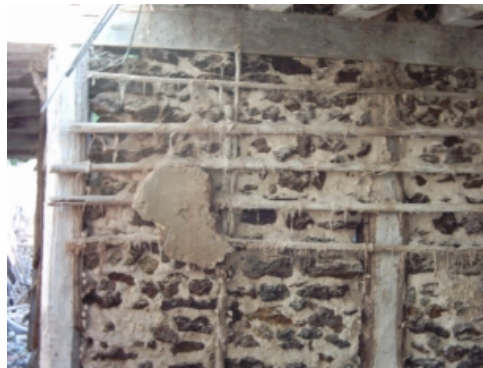
Figura 5: Desprendimiento de friso Casa en Maracaibo, Edo Zulia Fuente: Elaboración propia (2005)
