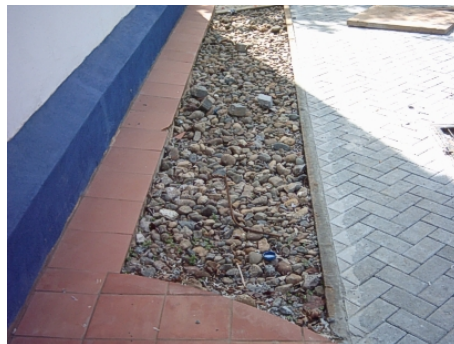
Figura 8: Zanja filtrante alrededor de edificación Iglesia San Isidro, Edo Zulia Fuente: Elaboración propia (2007)
