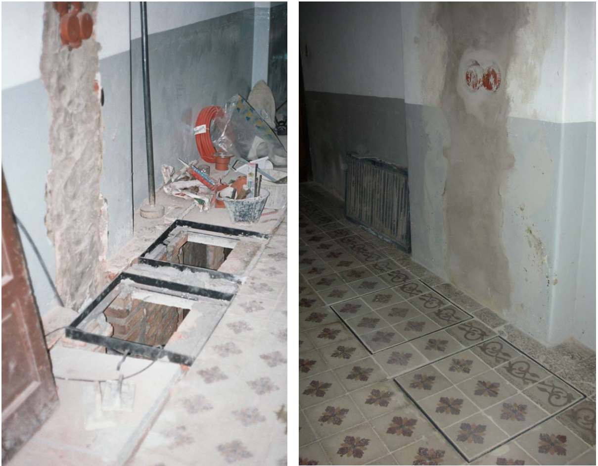
Foto 8 y 9. Tapas de inspección de la Cámara Bufo.
