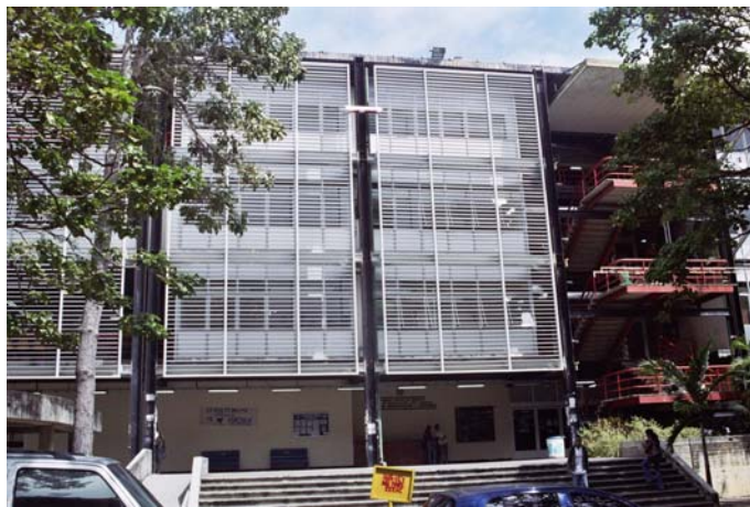
Figura 16. Vista de la nueva imagen de la edificación. Fuente: Arq. David Vitoria
