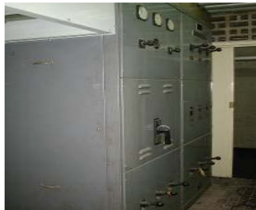
Fig. 3. Tablero central de alimentación
