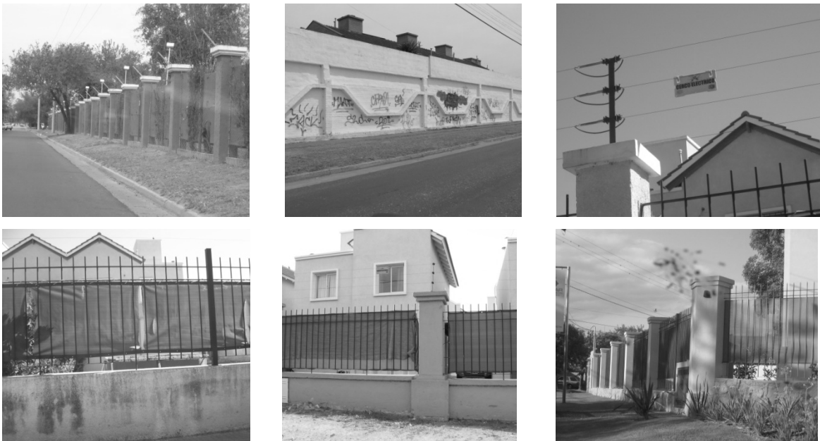
Fig. 9, 10, 11, 12, 13 y 14. Las imágenes dan cuenta de la secuencia de degradación del borde perimetral, Nótese, la precarización de los vallados en la búsqueda de la opacidad respecto del espacio público y la búsqueda de la seguridad que justifica la electrificación de los cercos. Fotos: Liborio, [2006-2008]
