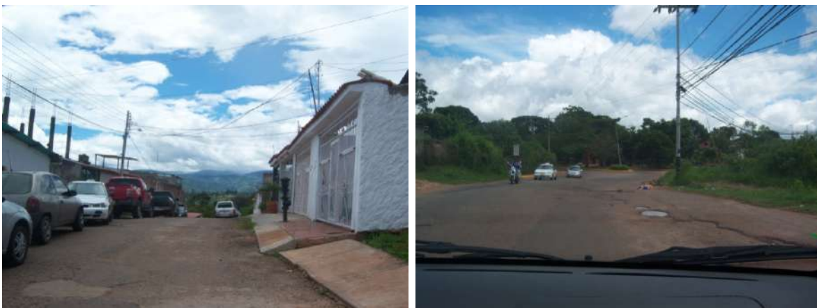
F7. y F8. Se aprecia el deterioro de la calzada, así como la discontinuidad o ausencia de aceras en todo el sector.
