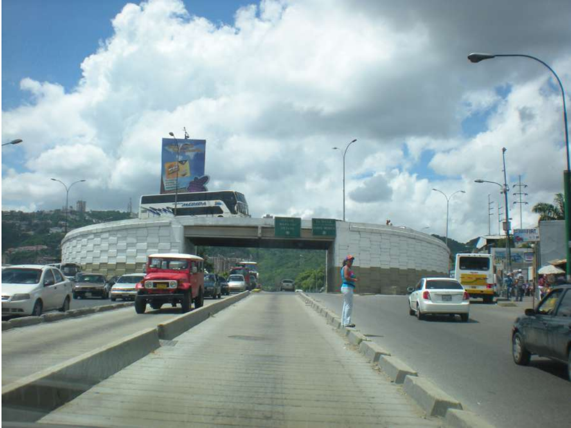
Figura 5. Obras del BusCaracas, Av. Nueva Granada, Terminal La Bandera. (Foto de las autoras, 2010)
