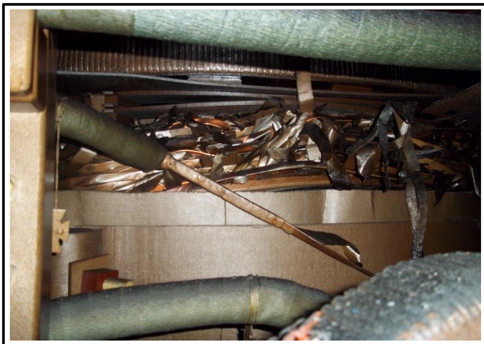
Figura 10. Deformación del devanado de alta tensión H1 (115 kV).
