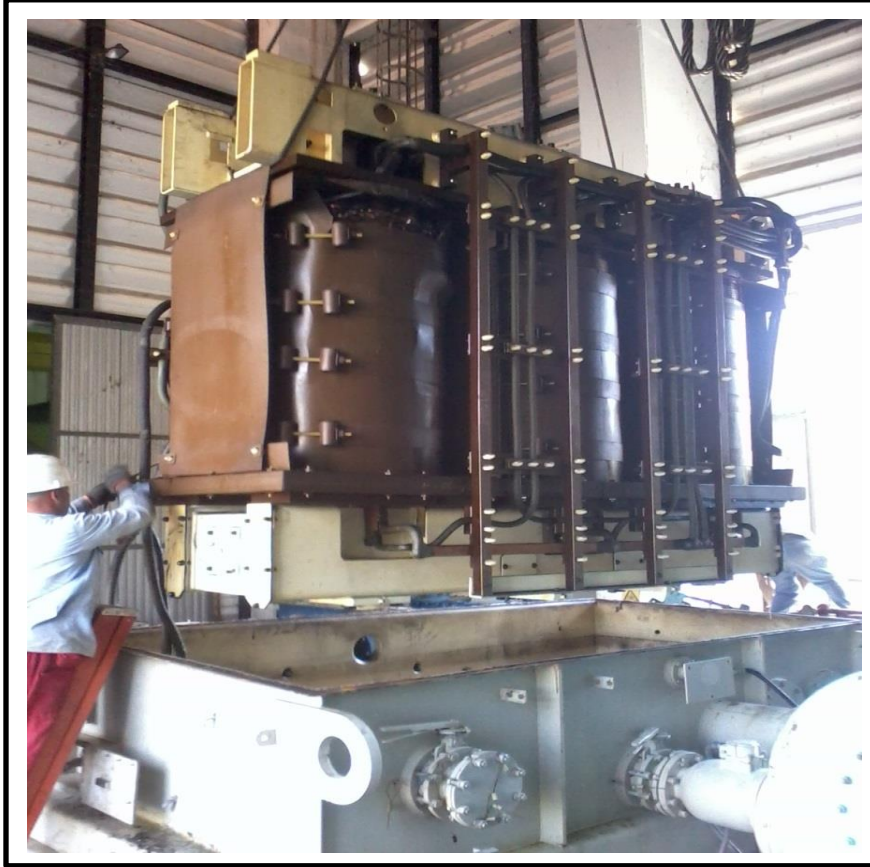
Figura 8. Desencubado de la parte activa del transformador de potencia de la S/E móvil IEM 26-1737.
