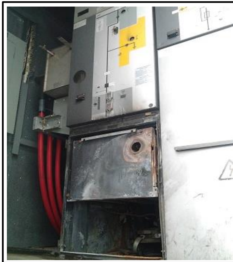
Figura 13. Celda de Interruptor Automático GIS CPG 1 (O-V), marca ORMAZABAL.
