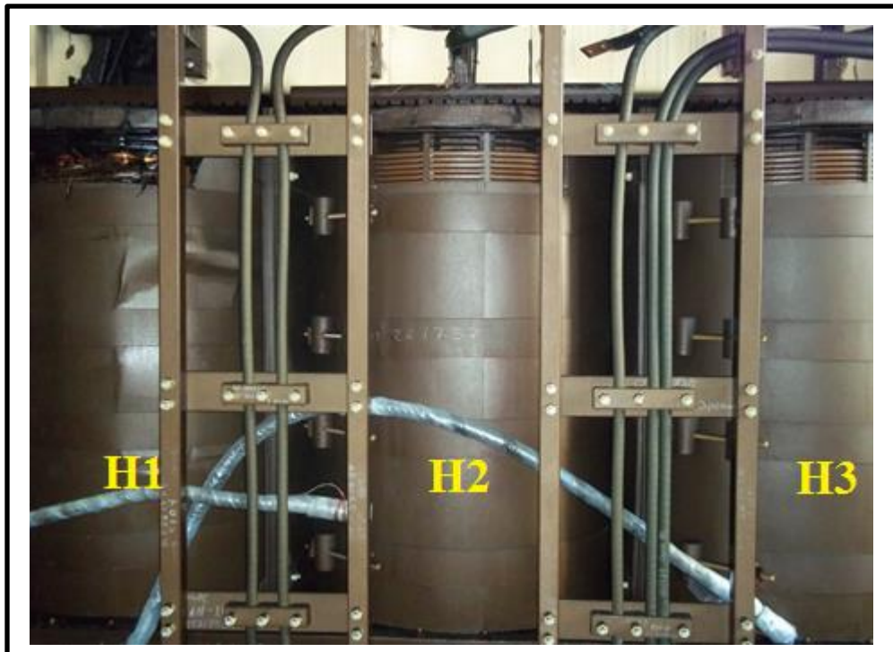
Figura 9. Parte activa de la S/E móvil IEM 26-1737, posterior a la falla.
