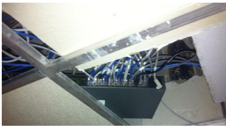
Figura 14. Conmutador del piso 1 Humboldt
