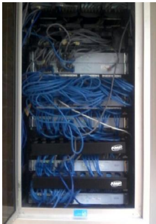
Figura 6. Gabinete del piso 4 Glorieta.
