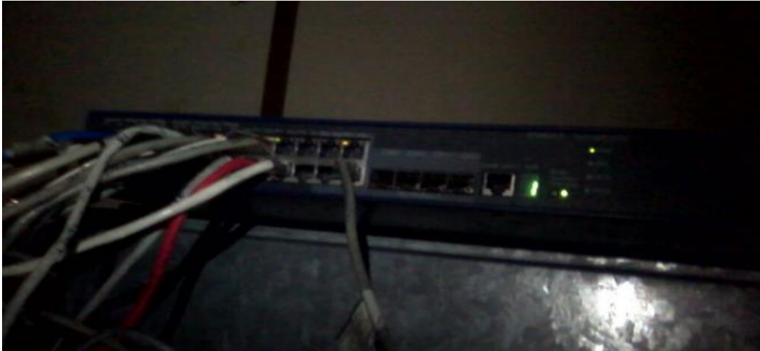
Figura 10. Conmutador piso MZZ Banvenez.
