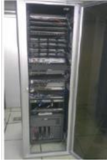
Figura 7. Gabinete del piso 1 Glorieta.
