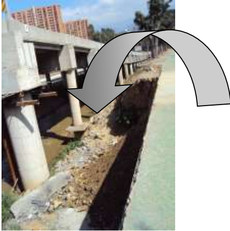
Figura No 21. Malas terminaciones en los elementos estructurales de la ampliación ejecutada a la altura del Paseo Los Ilustres.
