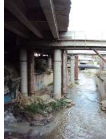
Figura No 22. Detalles de malos acabados y daños ocasionados al embaulamiento por columnas en el río El Valle vistas desde el puente Bellas Artes cruce con Av. La Facultad.
