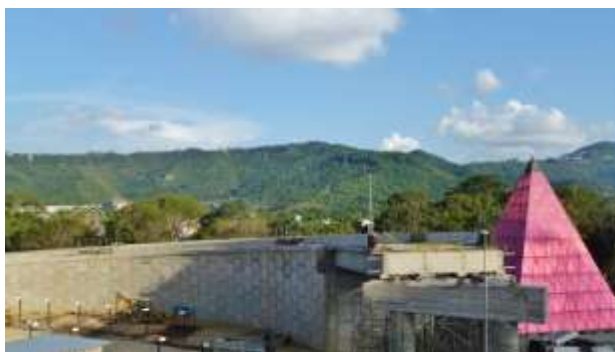
Figura No 7. Fase de construcción de la rampa de conexión con los túneles de la autopista Valle-Coche.
