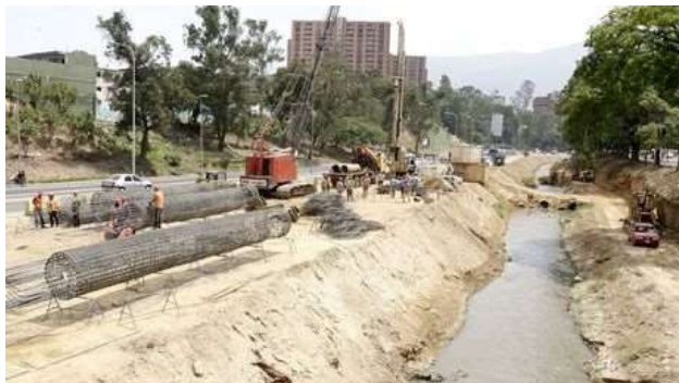
Figura No 10. Daños evidentes en las orillas del río El Valle como parte de las obras de ampliación de la Valle-Coche. Fuente: Ministerio del Poder Popular para Transporte Terrestre y Obras Públicas
