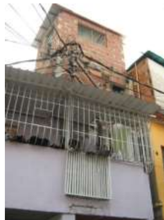
Figura 9. Detalle de poste de energía eléctrica incorporado a una vivienda.
