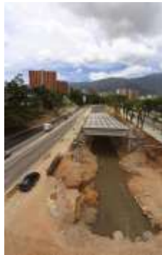
Figura No 15. Destrozos al embaulamiento por obras de ampliación en el río El Valle vistas desde la Bandera cruce con Paseo Los Ilustres.
