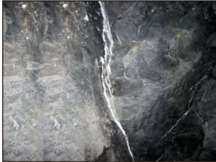
Figura 2.14 Relleno en discontinuidades
