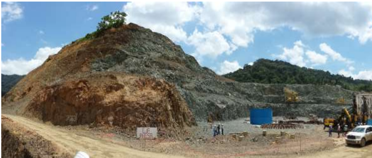
Figura 5.38 Vista panorámica en en sitio de construcción de la presa con la presencia de la falla rumbo N60W, 76W (030,76)
