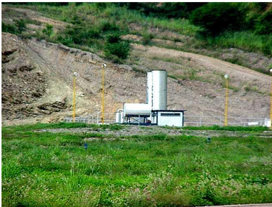
Foto 8.5. Vista de los Quemadores en la Terraza Norte
