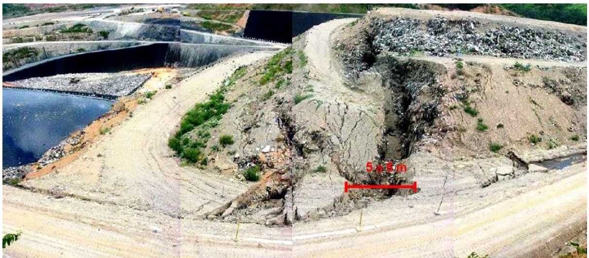
Foto 9.17. Grieta transversal actualmente (de 5 a 6 metros de ancho), (agosto 2002)
