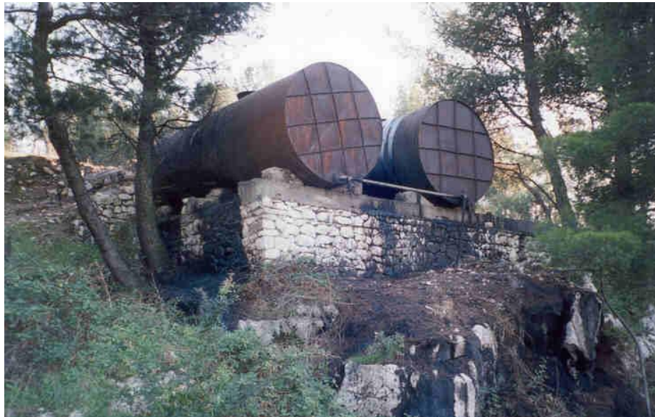
Foto 2.1. Contaminación superficial por escape de combustible de un tanque de almacenamiento
