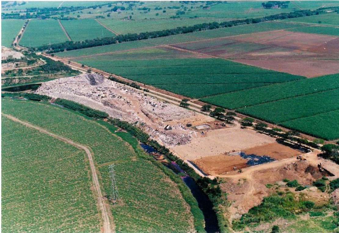
Foto 7.34. Preparación del sitio para la construcción de un nuevo relleno sanitario al cerro Navarro
