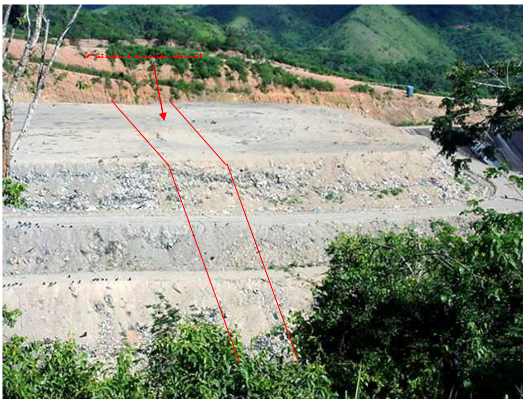
Foto 9.19. Grieta superior, a todo lo ancho de las celdas.
