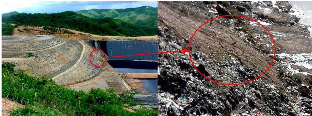
Foto 9.15. Grietas en la superficie del talud (junio 2002)
