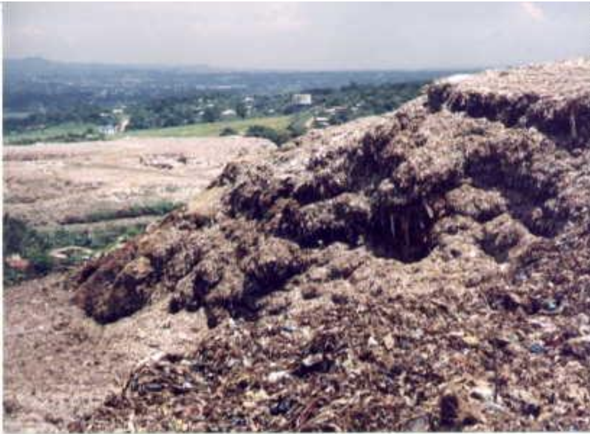
Foto 7.12. En esta fotografía se muestra la situación del vertedero en agosto de 2000, casi cuatro semanas después de ocurrir la falla. Los trabajos de rescate fueron suspendidos antes del cierre. La vista muestra la falla desde la cresta del talud no deslizado así como el área descubierta por el deslizamiento.
