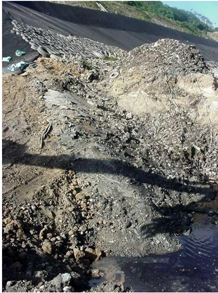
Foto 9.16. Corrimientos en la base del talud (julio, 2002)
