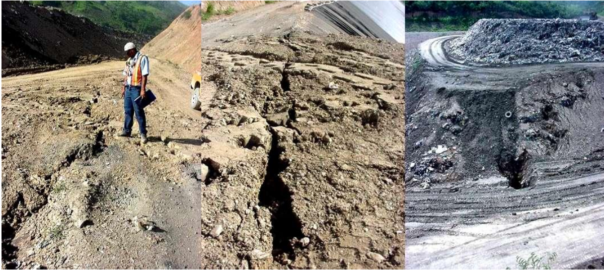
Foto 9.14. Grieta longitudinal (en la superficie de contacto entre los desechos y el talud sur) y transversal. Junio, 2002.
