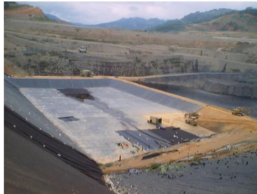
Foto 8.9. Colocación de la geomembrana y Geotextil en el Fondo de la Celda
