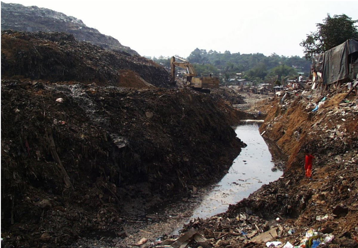
Foto 7.17. De manera de proteger el pueblo de los lixiviados que corrían fuera del vertedero, se abrió una zanja alrededor del área deslizada. (N14.71798° E121.10622°; 2 de agosto de 2000)
