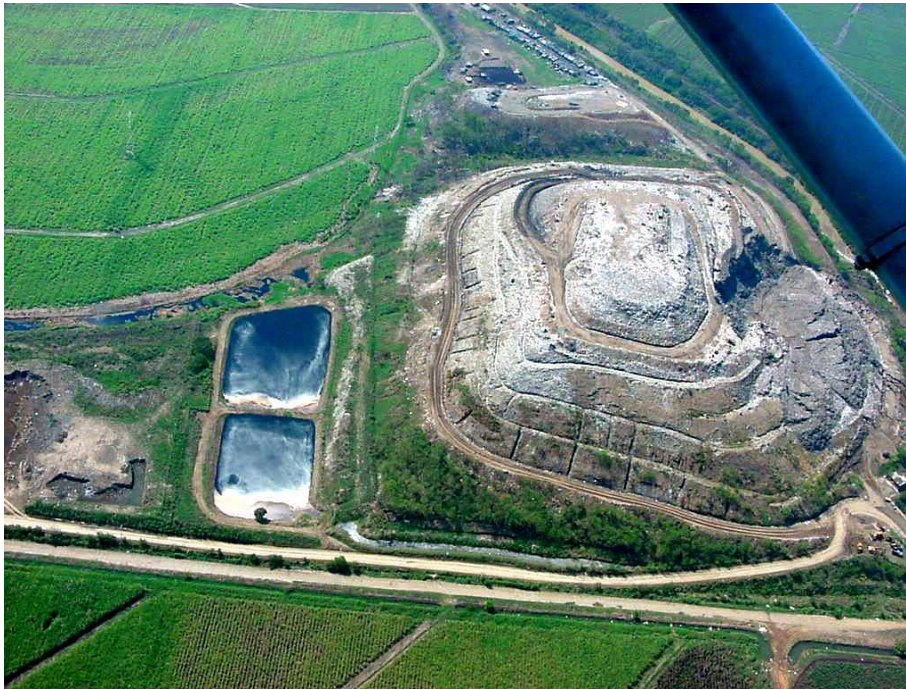
Foto 7.31. Vista aérea de una falla circular de un talud de basura en el relleno sanitario “Navarro” en Cali, Colombia
