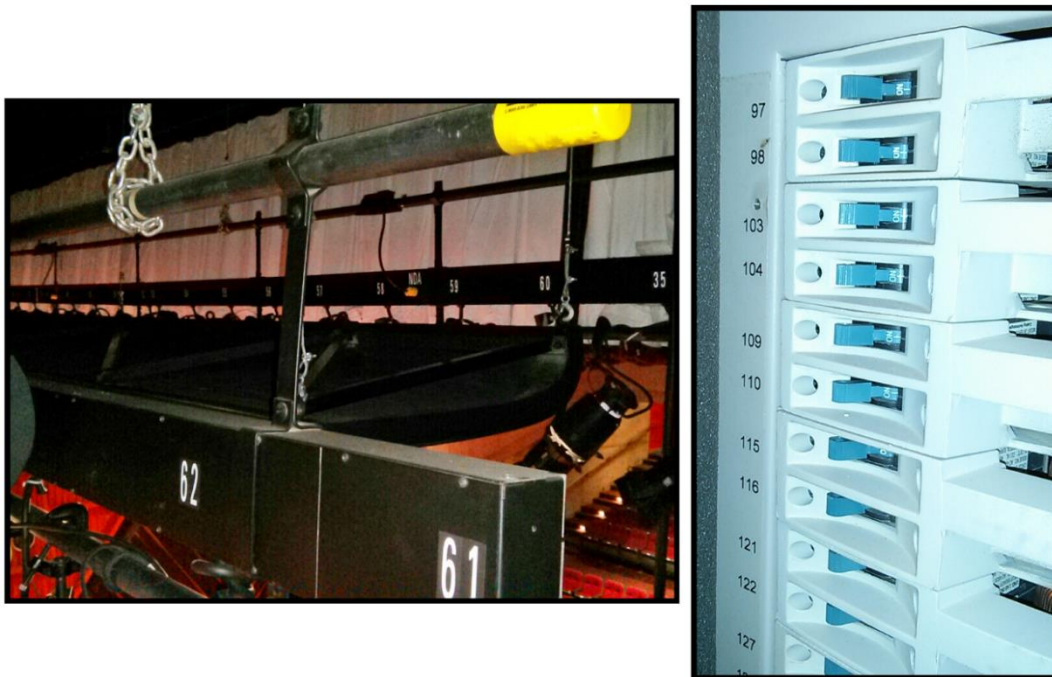
Figura 3.6.2.2b Barras / listones (izq.) y módulos de dimmer (der.) identificados con circuitos para “patcheo”
