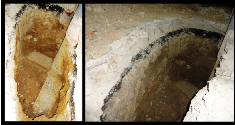
Figura 6.1.3e Presencia de materiales y/o elementos ajenos al suelo
