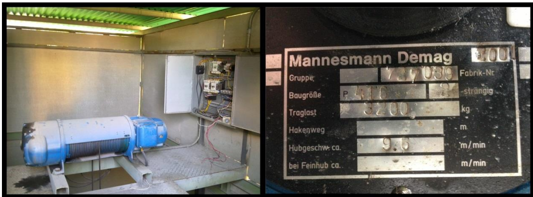
Figura 3.5.2 Sala de Máquinas y placa del motor del montacargas.
