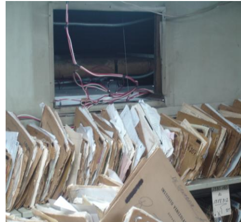
Foto 8. Expedientes en condiciones de riesgo
