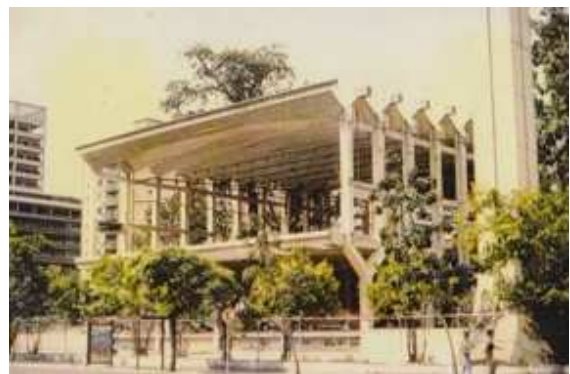
Figura 27. Estructura de paraboloides hiperbólicos del Cine Canaima posterior al incendio.
