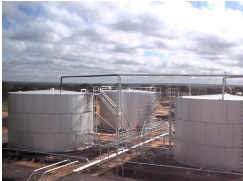
Figura 23. Tanque de Almacenamiento
