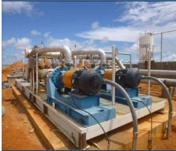
Figura 25. Bombas de Recirculación
